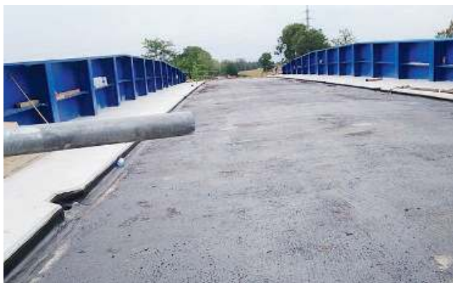
La strada. La gettata di cemento su cui passerà la strada provinciale
